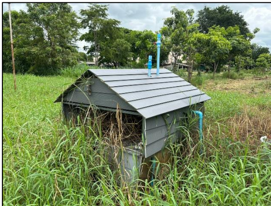
ถังเก็บน้ำ
