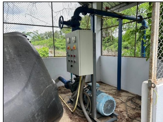
สถานีสูบน้ำดิบ
